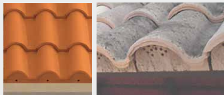
Aleros con barrera de pájaros para permitir la entrada de aire de la microventilación
