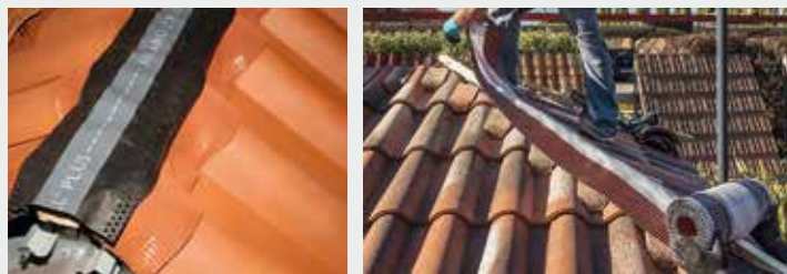
Instalación de bandas impermeables traspirables o microperforadas para conseguir la microventilación en cumbrera y limatesas
