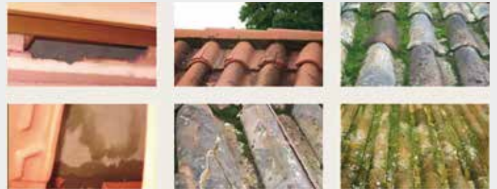
1. Condensaciones (ventilación insuficiente)
