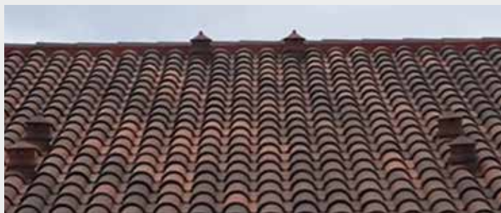
Posición desencontrada de chimeneas de ventilación.
