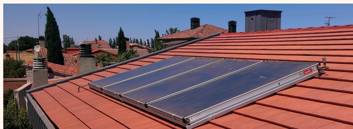
Figura 2. Paneles solares sobre cubierta inclinada de teja cerámica
